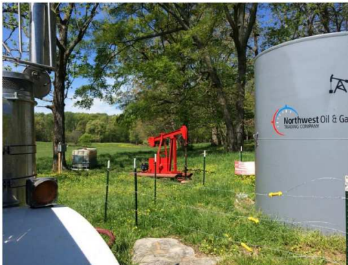
Pumpe und Öltank
